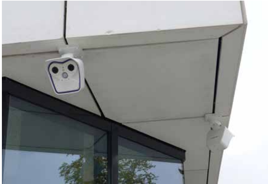
35 caméras MOBOTIX ont été installées : des M15 équipés de lentilles diurnes et nocturnes pour observer les environs immédiats, et des i25/p25 pour les principaux locaux.
