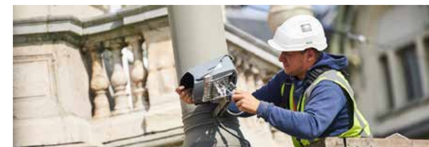
In Brussel installeert Engie Fabricom momenteel heel wat ANPR-camera's.
